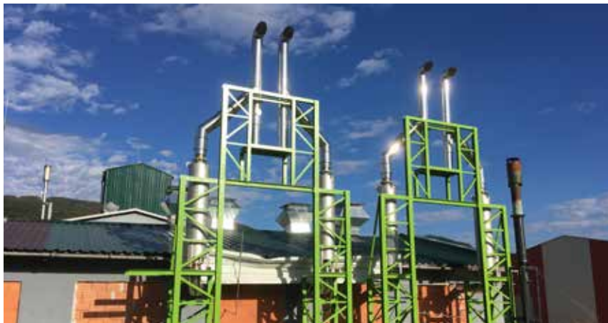
Foto: Komínové systémy pripojené na kogenerčné jednotky; Kokava nad Rimavicou.
